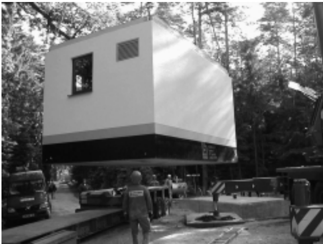
Aufbau des Pumpwerks zum Anschluß Moosbachs an die Feuchter Wasserversorgung im Sommer 2001.
